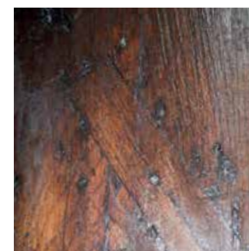
Trotz der starken Schädigung kann man die exzellente ursprüngliche Gestaltung und handwerkliche Ausführung erkennen. Zudem ist das Material erstklassig. Umso schöner, dass auch diese Tür gerettet wird – erste Sanierungsschritte sind bereits sichtbar.
